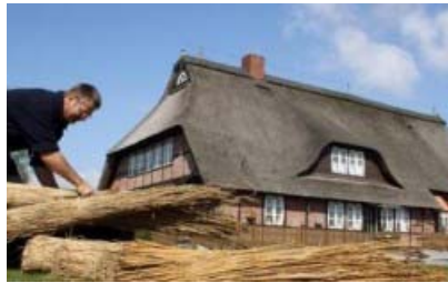
Ein Helfer legt Reetbündel auf einen Haufen: Feuchtwarme Luft kann in Verbindung mit Fehlern bei Konstruktion und Bauausführung die Lebenszeit von Reetdächern deutlich verkürzen. (Bild: dpa)
